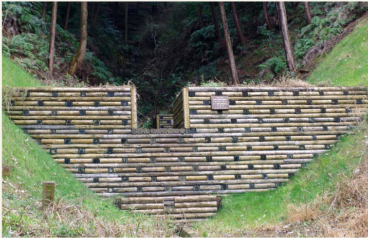
平成 27 年西条市西泉の赤谷川支流に設置された木製ダム
